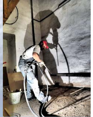
Spezialisten heilen Gebäudewunden
